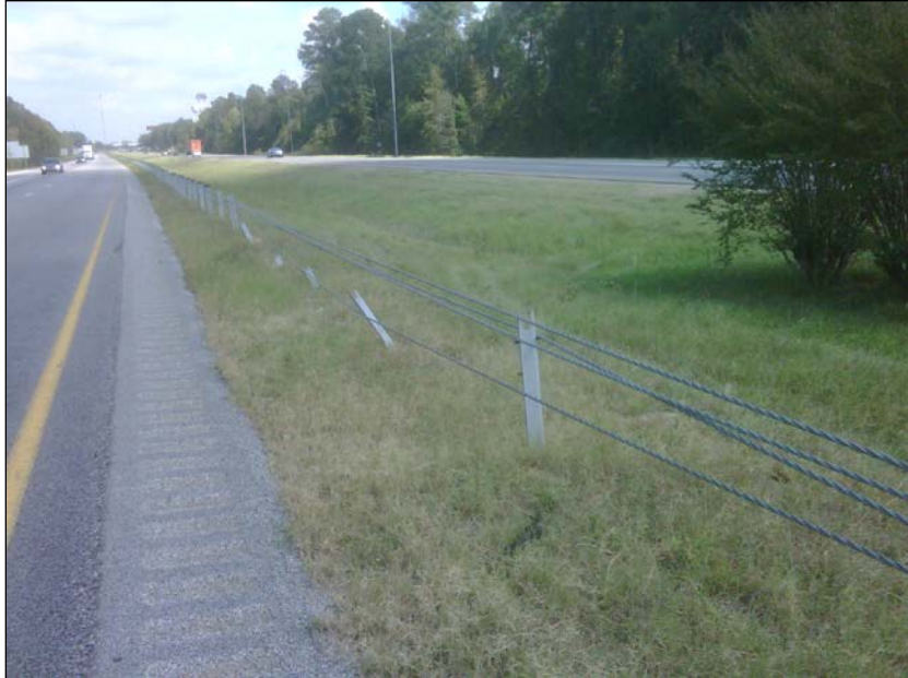
Deficient Cable Barrier:
